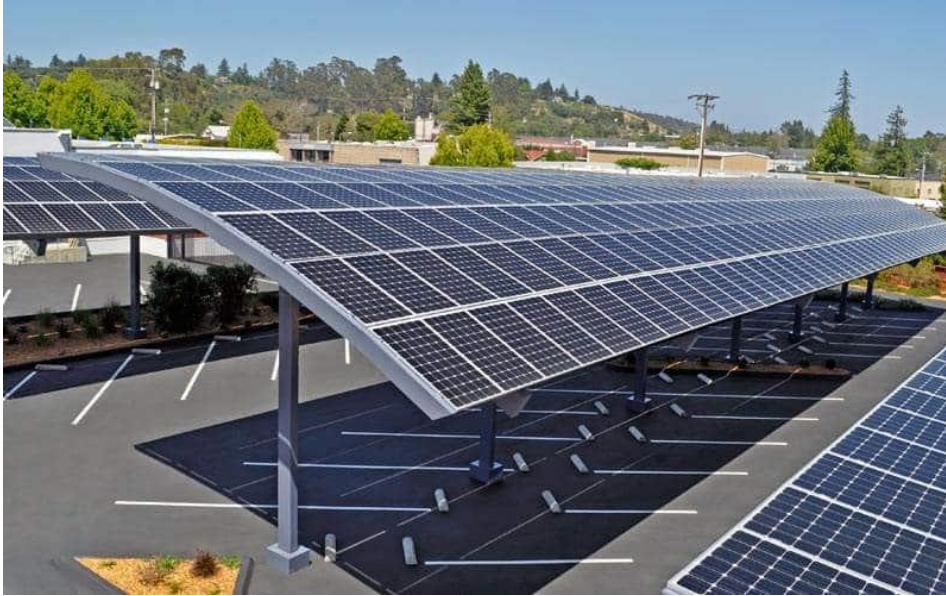
Exemple d'ombrières photovoltaïques. Source : https://www.id-solaire.fr/
