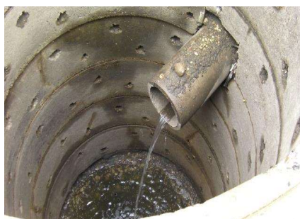
Alimentation d'un puits Source : Bourguiclic
