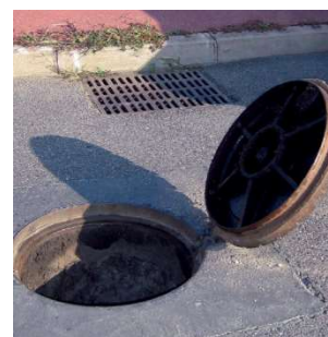
Puits et regard de décantation Source : Grand Lyon
