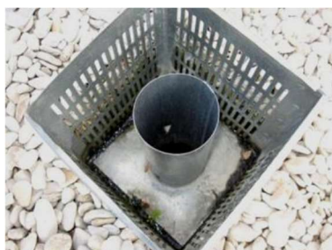
Ouvrage de régulation avec grille de protection. Source : Sepia Conseils
